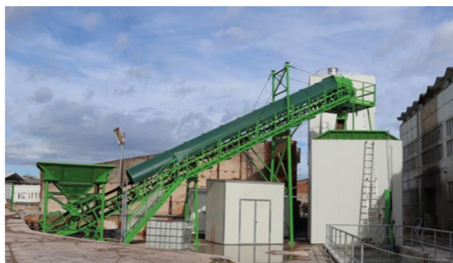
Blick auf die Beschickereinheit der neuen Mischanlage
