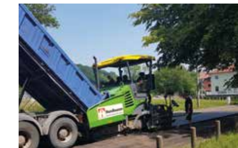
▲ Voegle Raupenfertiger SUPER 1600-3i mit einer max. Einbaubreite von 7,50 m, einer max. Einbaukapazität von 600 t/h und einer Motorleistung von 116 kW
