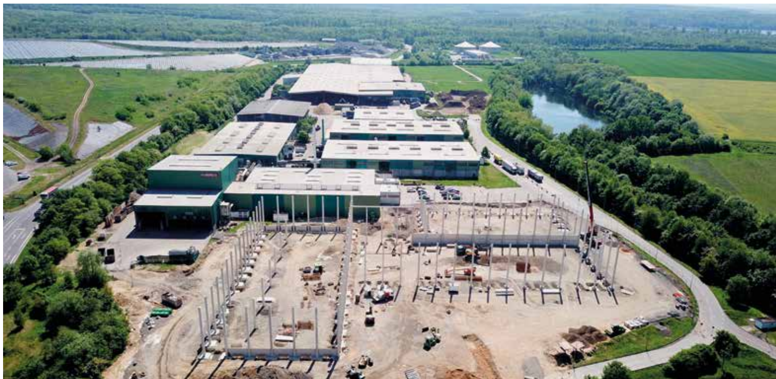
▲ Neubau der Leichtverpackungs-Sortieranlage auf dem Deponiegelände des Verwertungszentrums Erftkreis (VZEK) im Mai 2018
