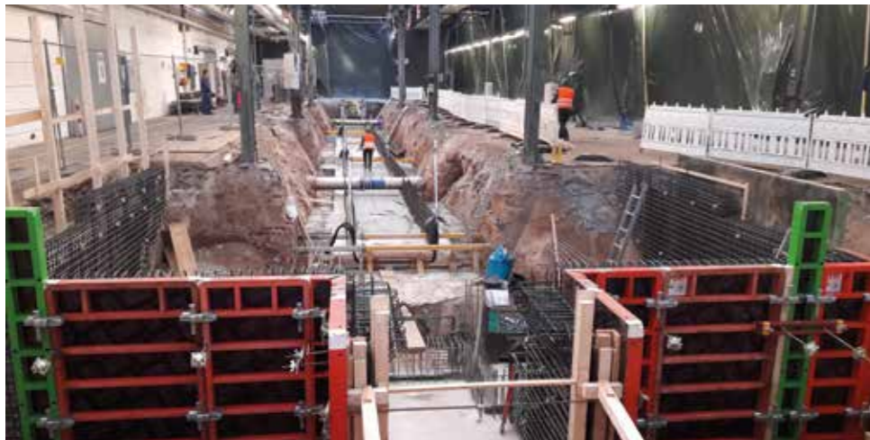
▼ Im Vordergrund ist die Wandschalung des Fluchttunnels erkennbar, im Hintergrund werden die aufgehenden Grubenwände vorbereitet.
