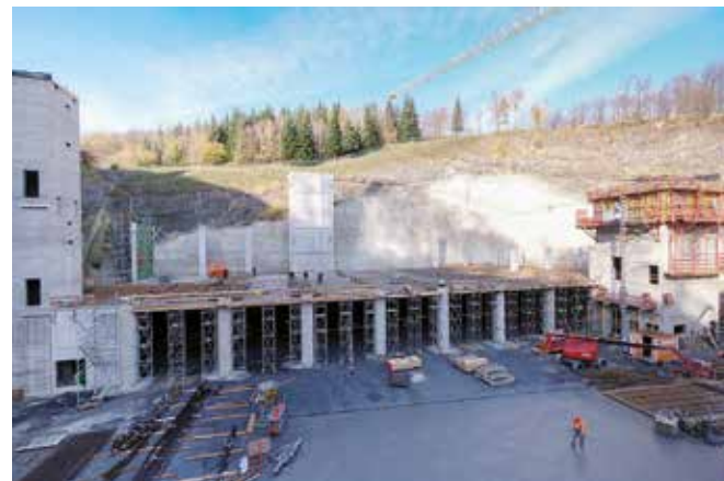
Neubau eines Abfüllgebäudes für die VELTINS GmbH & Co. KG in Meschede, Seite 8-9
