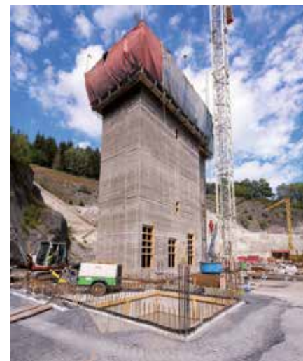
Gleitbau des Schachtbauwerks T5. Hier sollen einmal Lastenaufzüge in Betrieb genommen werden.
