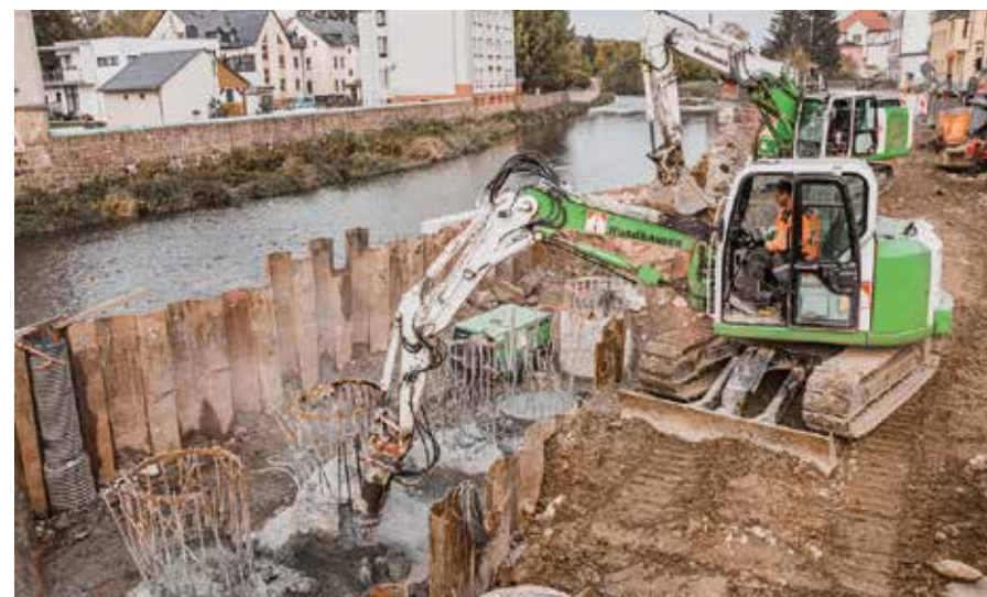
Die erforderlichen Abfräsarbeiten der Bohrpfahlköpfe an Achse 20 in Flöha sind in vollem Gange.
