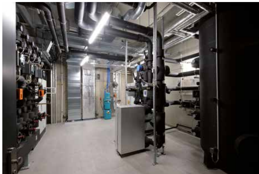
Ein Beispiel einer technischen Anlage, die von uns gewartet wird.
