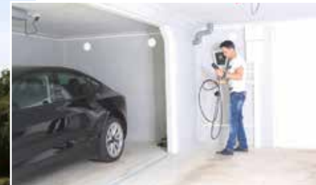
Eine Wallbox in der Doppelgarage, die Zukunft hat hier bereits begonnen!
