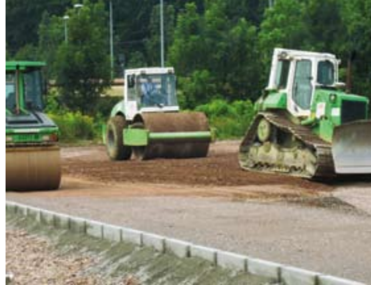
▲ Abgestimmter Einsatz von Planierraupe, Walzenzug und Glattradwalze bei der Herstellung des Frostschutzplanums
