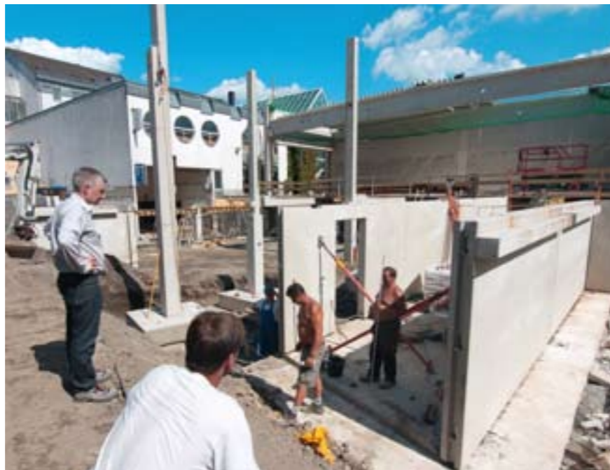
Bauleiter Juri Manweiler vom Fertigteilewerk begutachtet den Aufbau von Fertigteilmauern im Bereich der Technikzentrale
