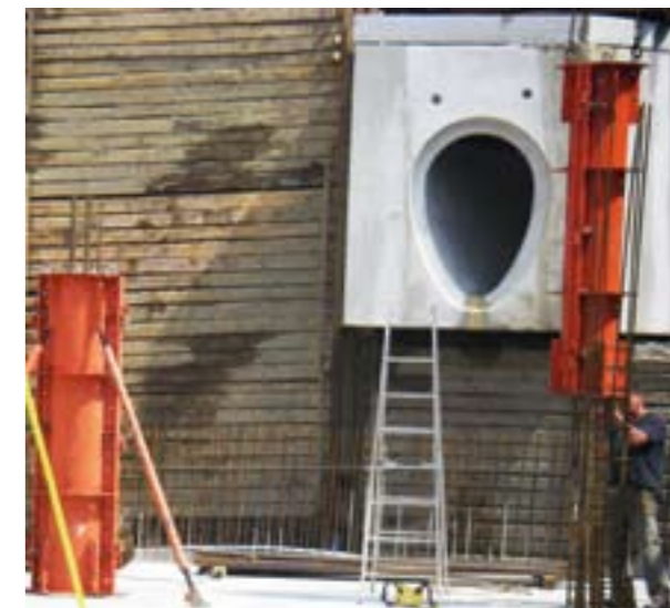
▼ Einlauf Schmutzwasserkanal zur Anbindung an das RÜB und Schalung für die Rundstütze
